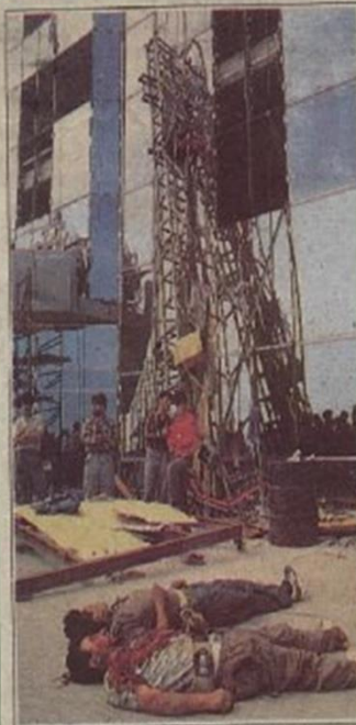
22. KATTAN DÜŞTÜLER Ataköy'de 25 katlı Crown Plaza Otel inşaatında çelik çarpanların baskı lastikleri ni yapıpıran üç işçi, elektrikli işçiyi taşıyan çelik halatın kopması sonucu iskeleyle birlikte 22. kattan beton zemine çakılarak can verdi. ▶ Erkan AYÇILARIN HABERİ 18. SAYFADA
