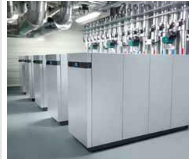
Tesisat dairesi (İç ünite)
