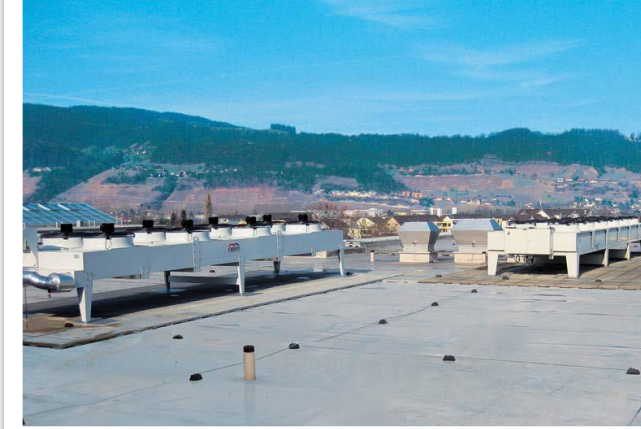
Çatıda kurulan kuru soğutucular (Dış ünite)
